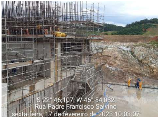
Foto 190 – Vista geral das atividades construtivas na frente de serviço da fundação. (Data:17/02/2023)
