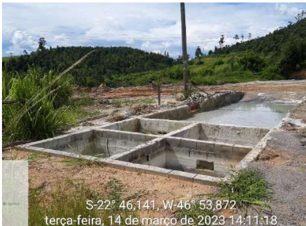
Foto 146 – Sistema de Tratamento de Efluentes utilizado para coleta de resíduos de concreto das betoneira. (Data:14/03/2023)
