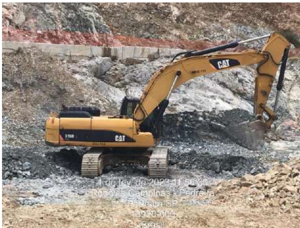
Foto 188 – Vista geral das atividades construtivas na frente de serviço da fundação. (Data:01/02/2023)
