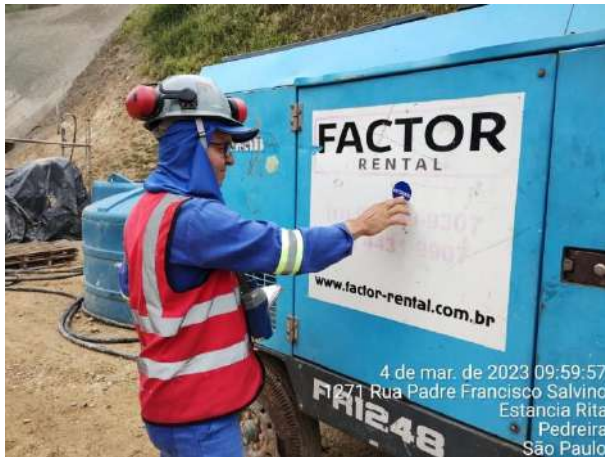
Foto 72 – Check list mensal de Compressor. (Data:04/03/2023)
