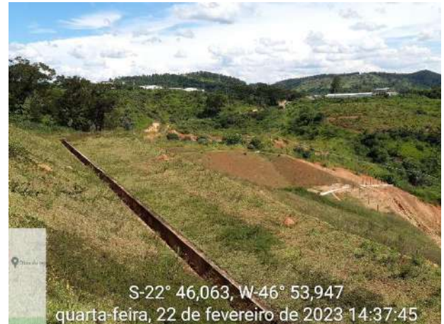
Foto 131 – Canaleta de berma para a coleta de águas pluviais que escoam na superfície do talude. (Data:22/02/2023)
