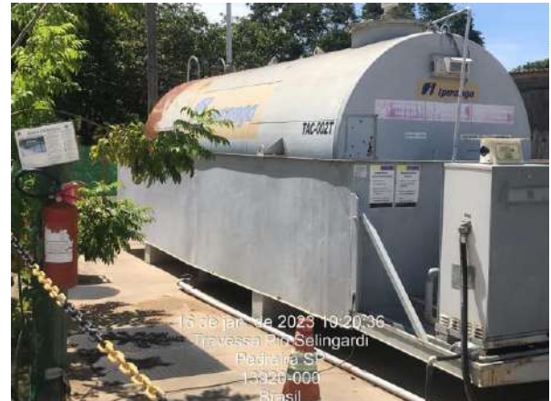
Foto 18 – Ponto de abastecimento no pátio da oficina mecânica. (Data:16/01/2023)
