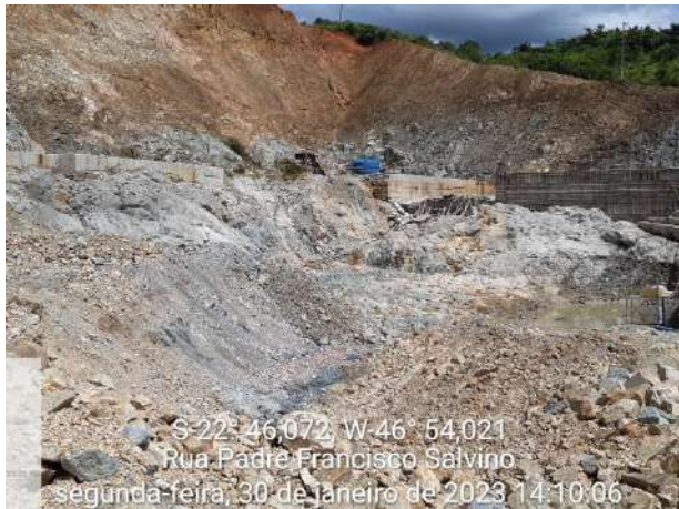
Foto 184 – Vista geral das atividades construtivas na frente de serviço da fundação. (Data:30/01/2023)
