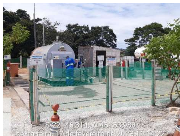
Foto 22 – Ponto de abastecimento no pátio da oficina mecânica. (Data:17/02/2023)
