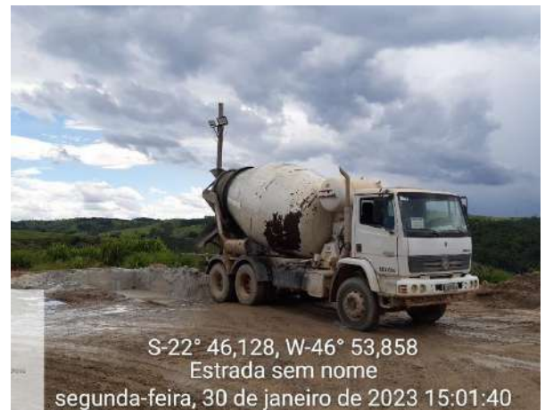
Foto 143 – Sistema de Tratamento de Efluentes para lavagem de bicas de betoneira no canteiro da usina de concreto. (Data:30/01/2023)
