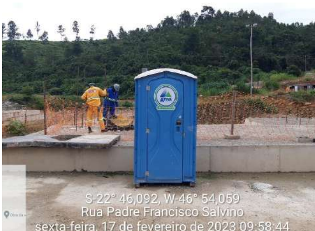
Foto 158 – Vista do sanitário químico disponível na frente de serviço. (Data:17/02/2023)
