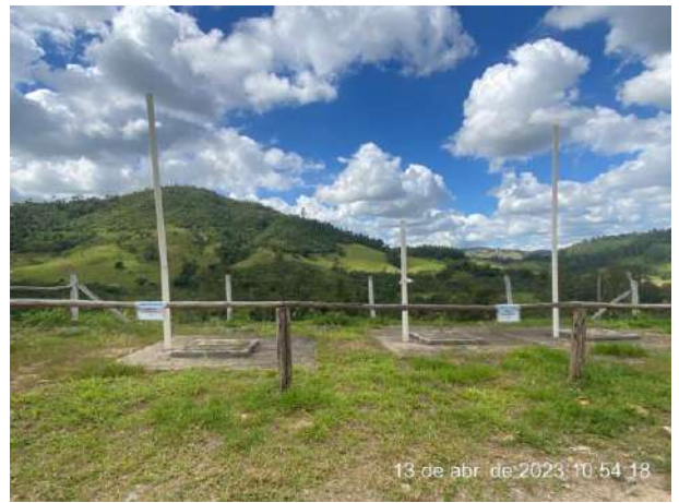
Foto 161 – Biodigestor 02 no canteiro administrativo. (Data:16/04/2023)
