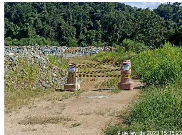
Foto 109 – Sinalização em cones “não ultrapasse” implantada na via interna da obra. (Data:09/02/2023)
