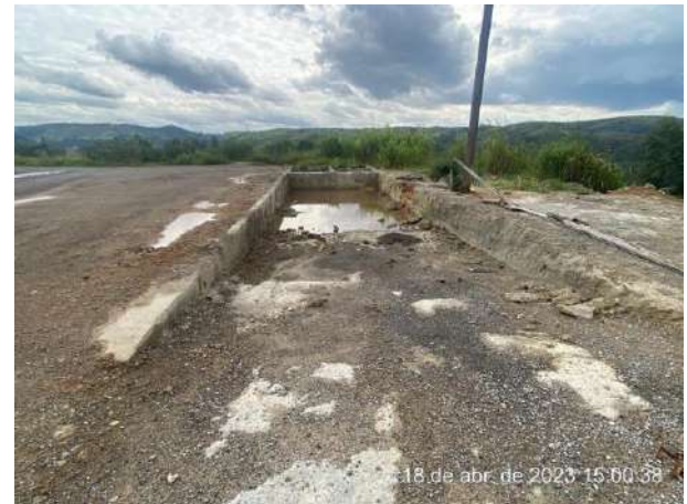
Foto 147 – Sistema de Tratamento de Efluentes para lavagem de bicas de betoneira no canteiro da usina de concreto. (Data:14/04/2023)
