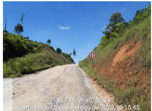
Foto 107 – Sinalização vertical implantada em via externa. (Data:15/02/2023)
