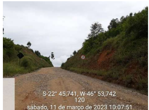
Foto 117 – Sinalização vertical implantada em via externa. (Data:11/03/2023)
