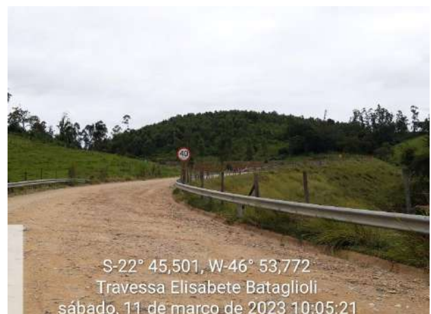
Foto 115 – Sinalização vertical implantada em via externa. (Data:11/03/2023)
