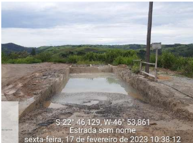
Foto 144 – Sistema de Tratamento de Efluentes utilizado para coleta de resíduos de concreto das betoneira. (Data:17/02/2023)
