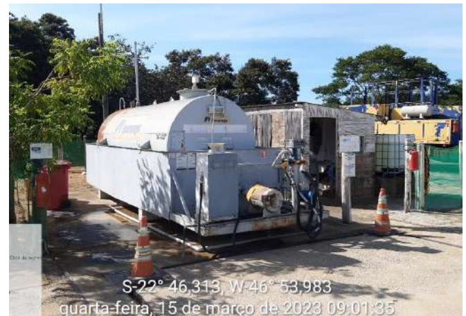
Foto 26 – Ponto de abastecimento no pátio da oficina mecânica. (Data:15/03/2023)
