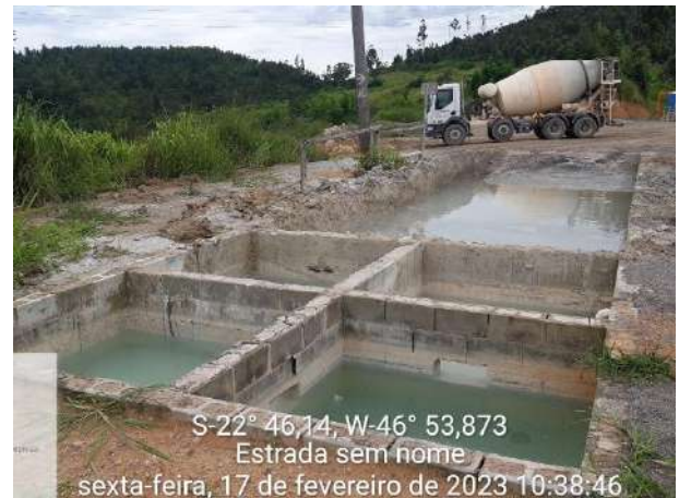
Foto 145 – Sistema de Tratamento de Efluentes para lavagem de bicas de betoneira no canteiro da usina de concreto. (Data:17/02/2023)
